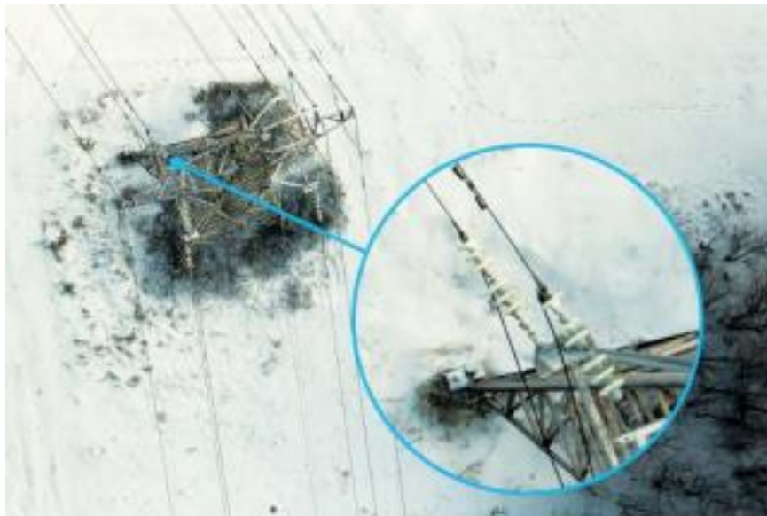
Рисунок 2.1 - Визначення технічного стану повітряних ліній, виявлення дефектів за допомогою БПЛА (виявлення пошкодженого ізолятора)
